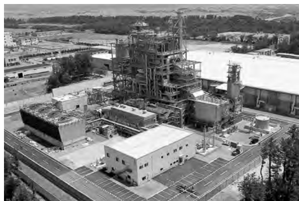
鳥海南バイオマス発電所
